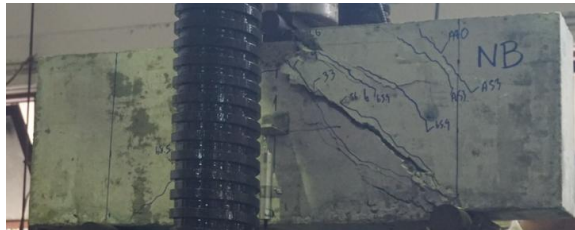
รูปที่ 13 การวิบัติของคาน 1
