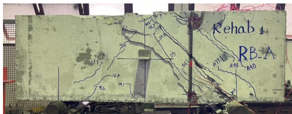
รูปที่ 14 การวิบัติของคาน 2
